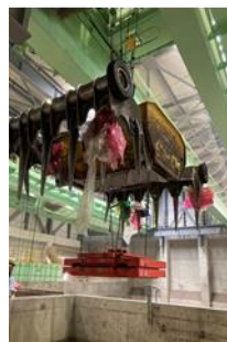
※ごみクレーン※
